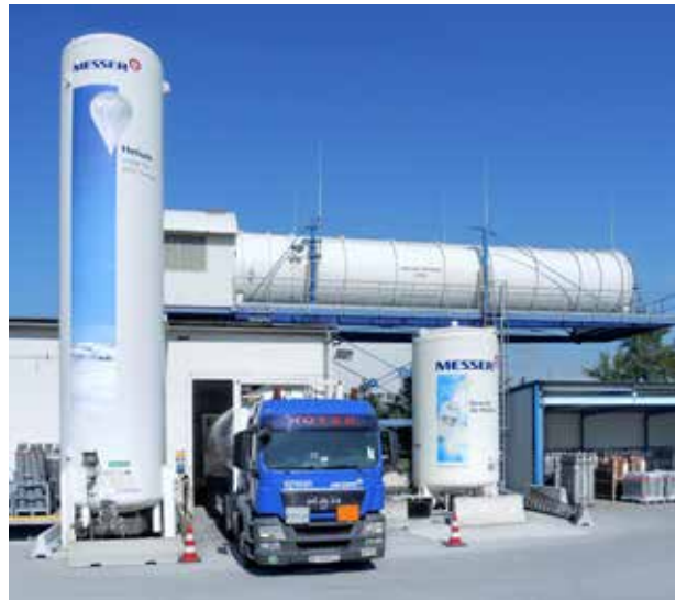
Réservoir de stockage couché d'une capacité de 120'000 l
